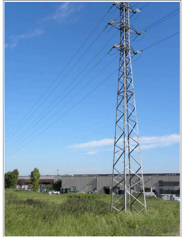
Particolare linea elettrica esistente
