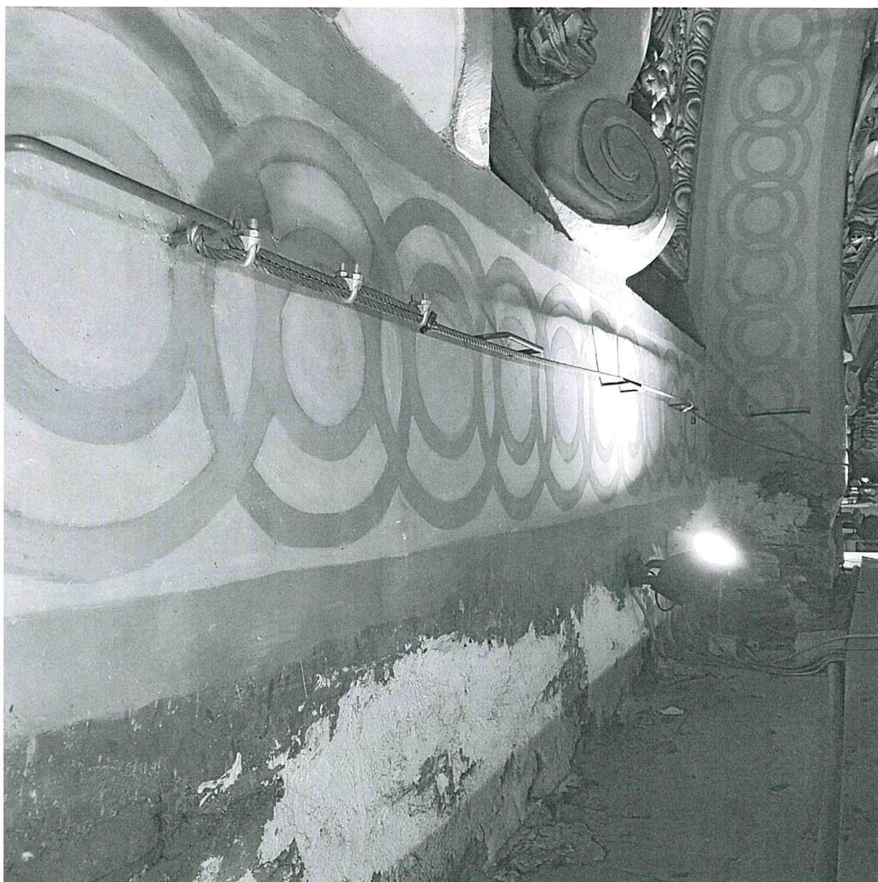
Attuale impianto di illuminazione
