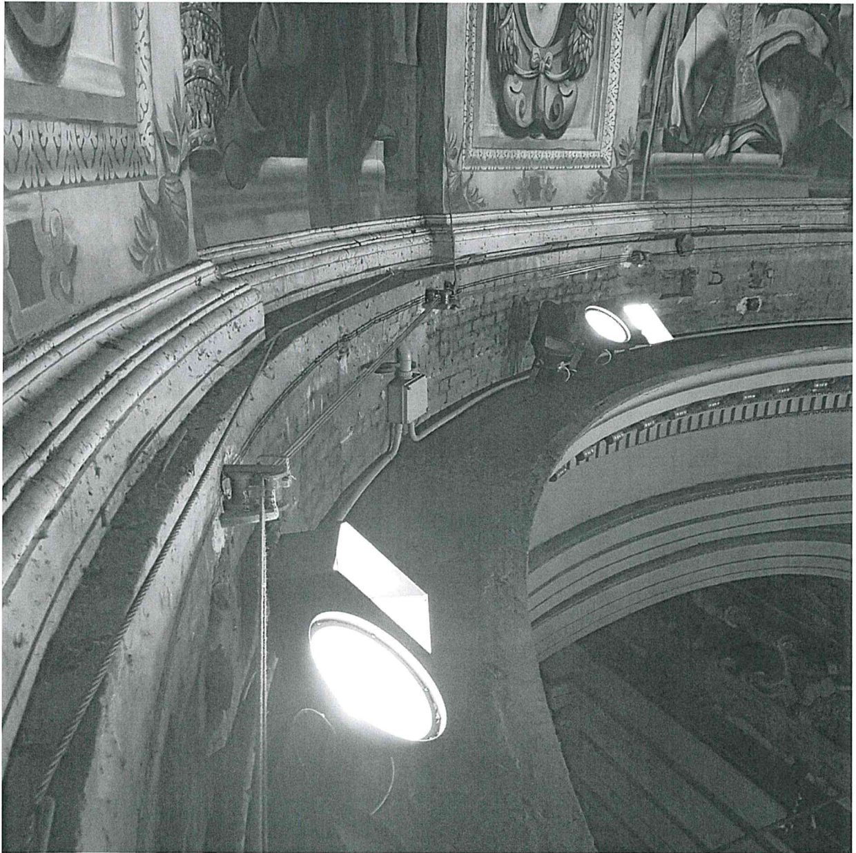
Attuale impianto di illuminazione
