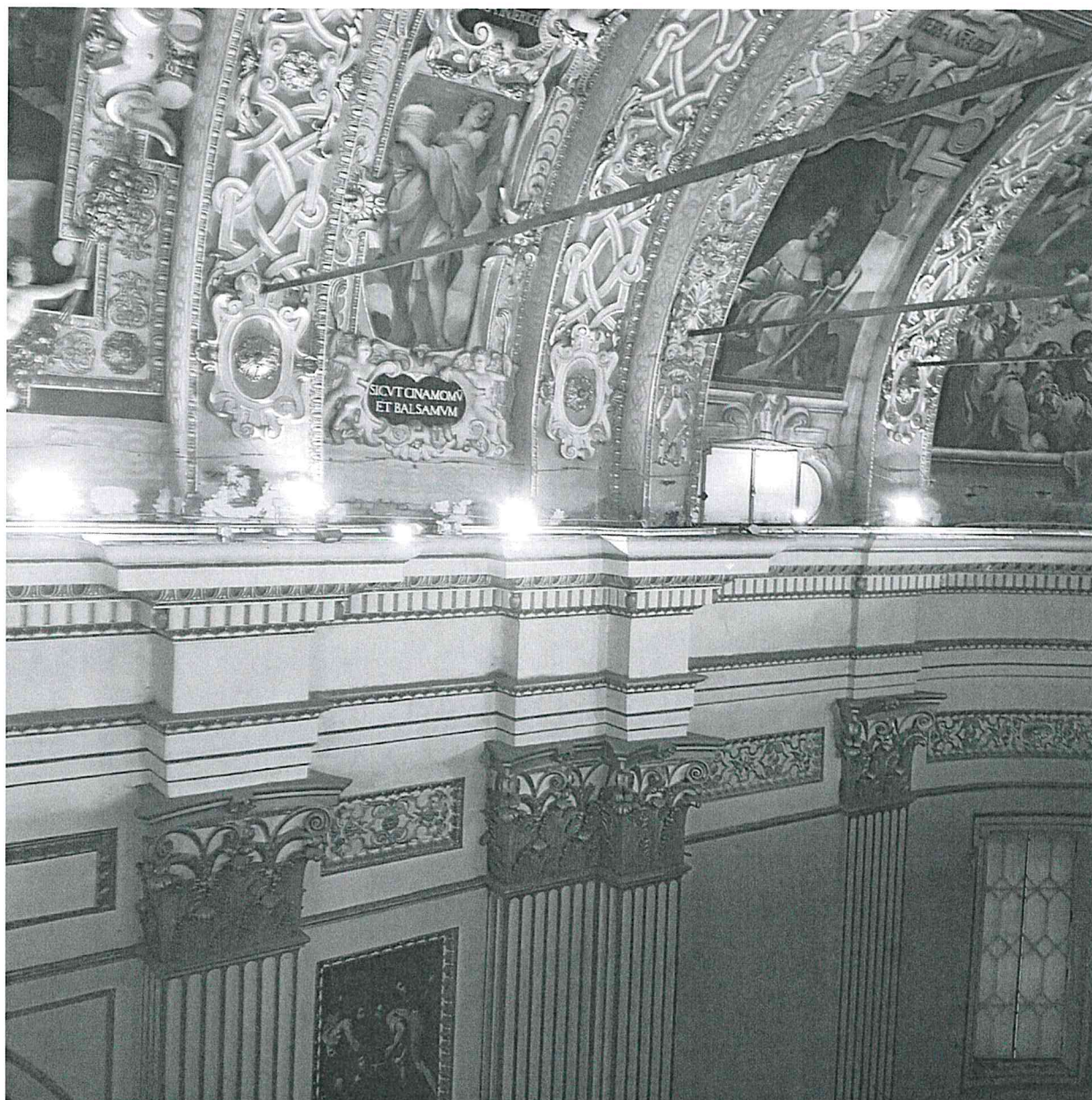
Attuale impianto di illuminazione
