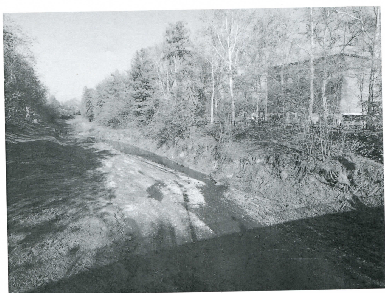
Figura 1 Torrente Crostolo, erosione argini
