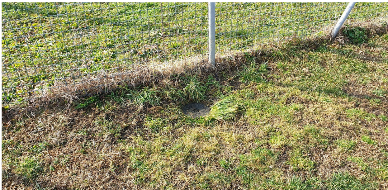
Irrigatore a scomparsa esistente sul lato Sud del campo
