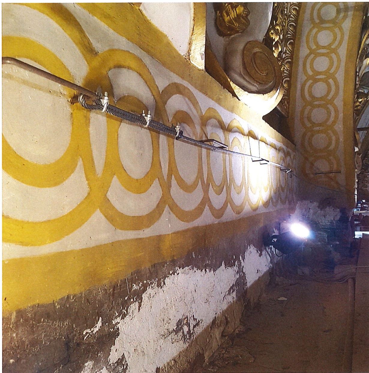
Attuale impianto di illuminazione
