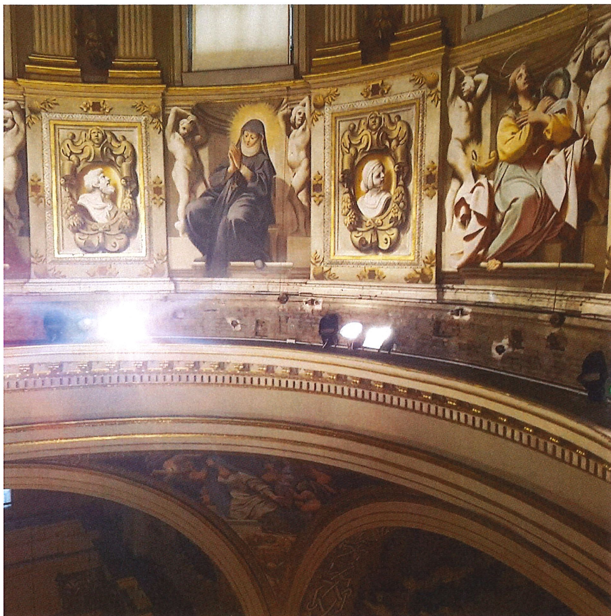
Attuale impianto di illuminazione
