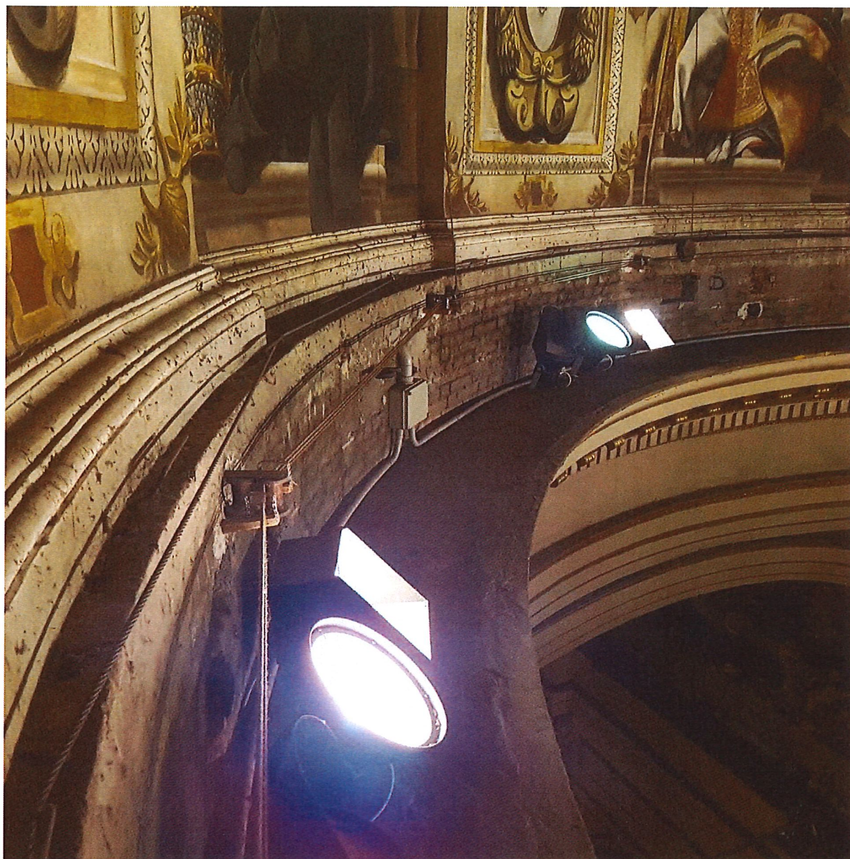
Attuale impianto di illuminazione
