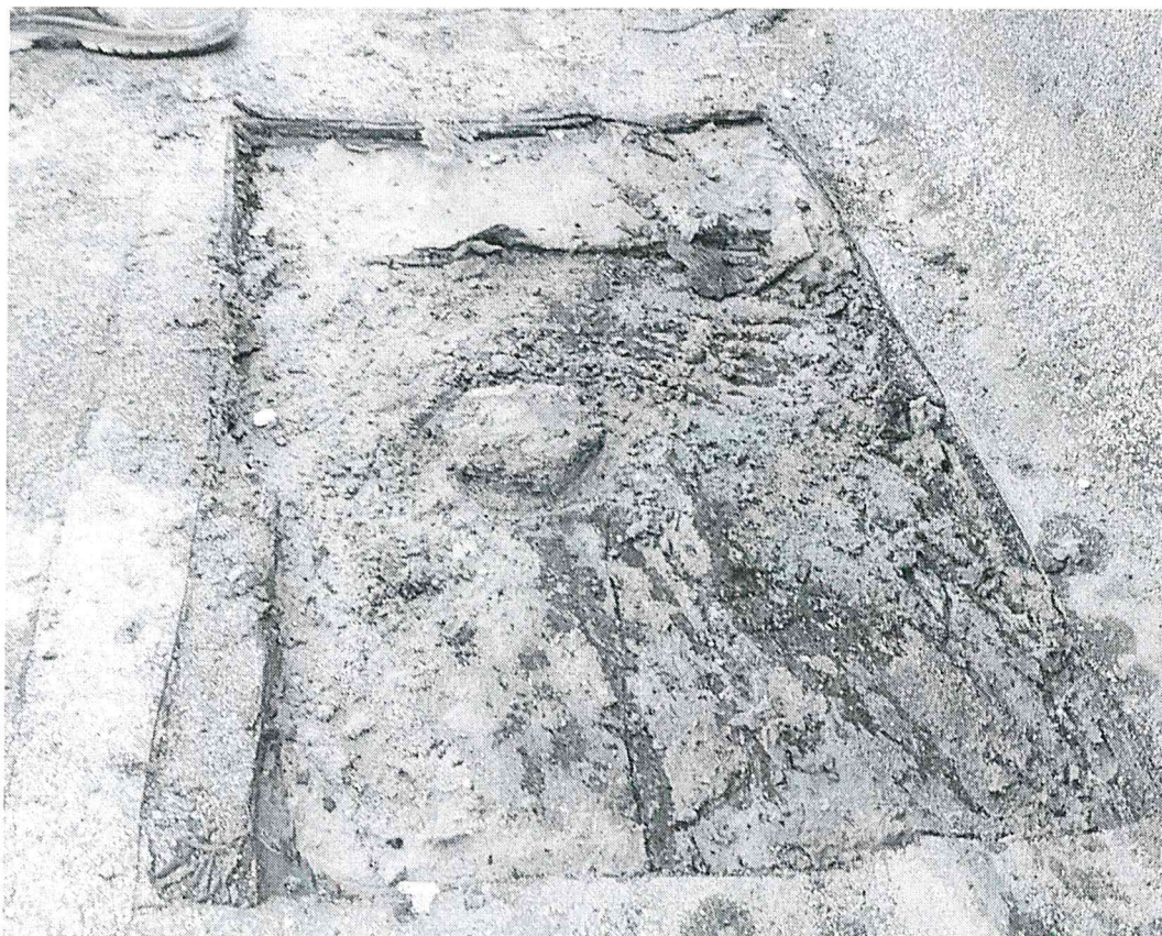
Figura 2: Situazione superficiale della copertura in un punto di accumulo
