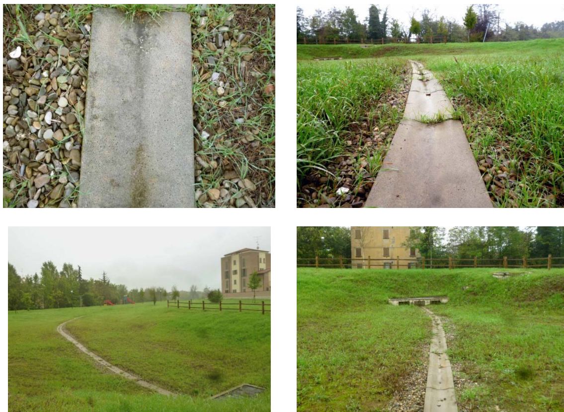
Figura 13. Vasca infiltrante recentemente realizzata a Canali (Reggio Emilia). Si noti la canaletta alla francese, realizzata con pendenza di circa 1%, impostata su un canale di infiltrazione a cielo aperto
