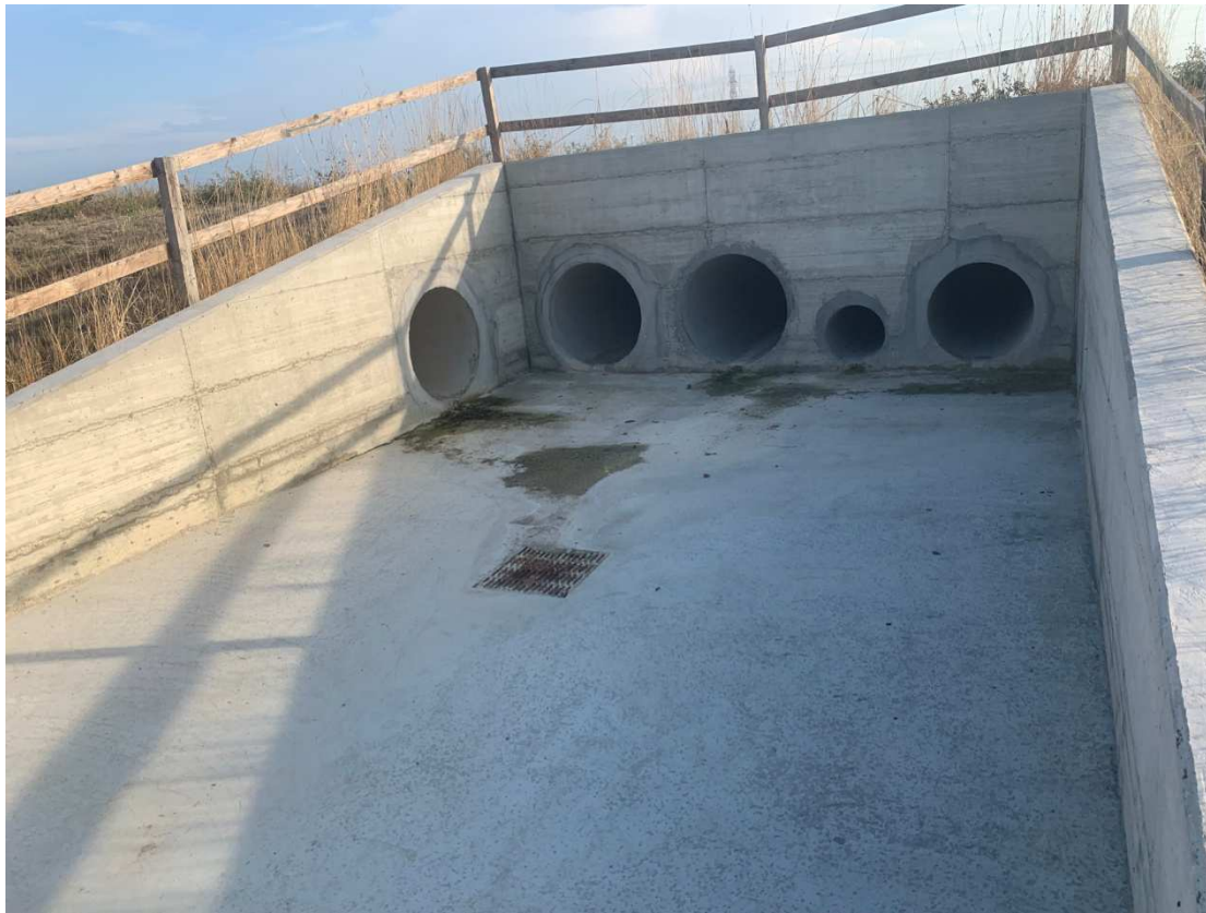
Manufatto in c.a. di scarico DA DEMOLIRE E RICOSTRUIRE
