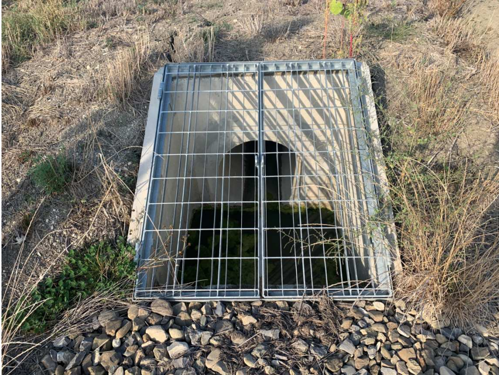
Pozzetto in c.a. e griglia di separazione tra invaso profondo e superficiale
