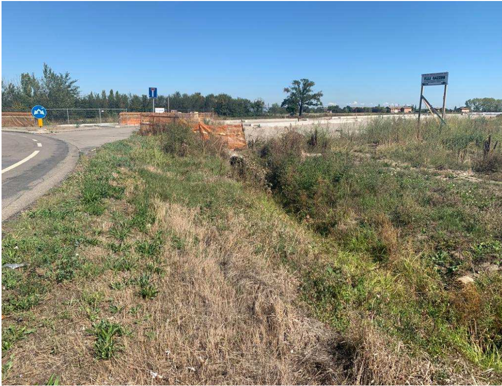
Tombamento verso ASP1 (lato sud)
