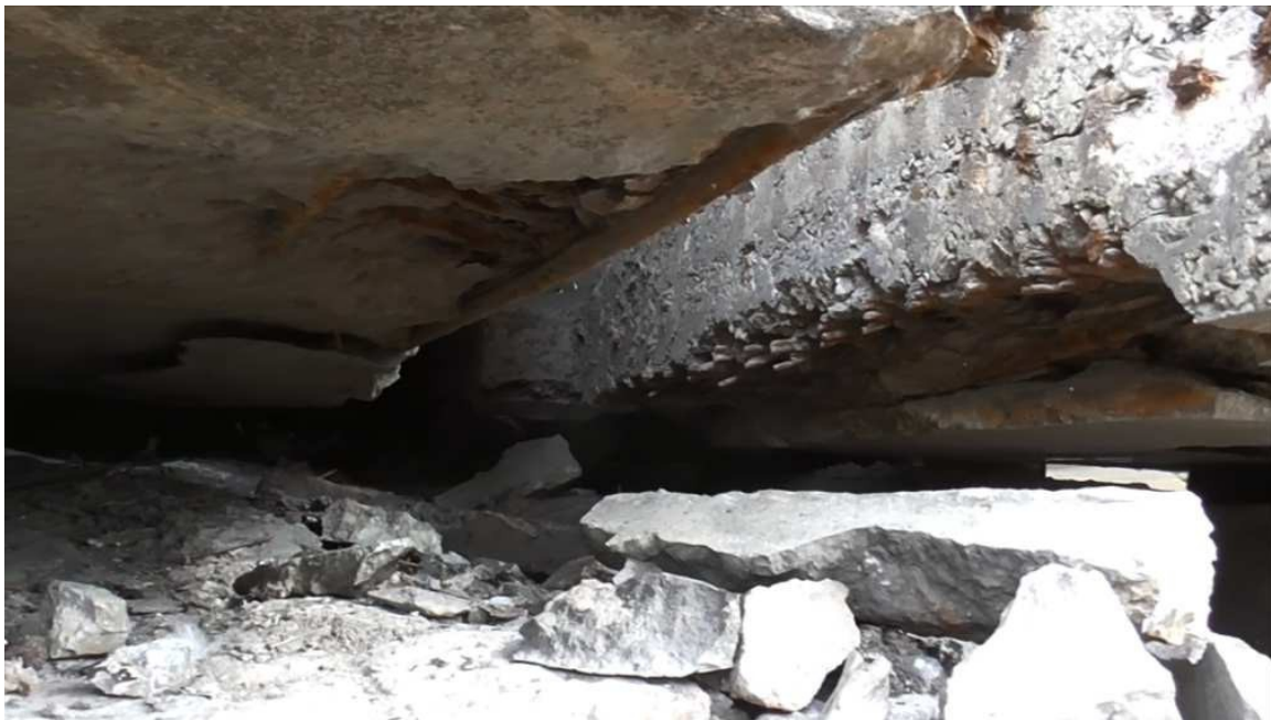
Fig. 1.3.3-Degrado delle travi in posizioni non raggiungibili a causa degli spazi limitati
