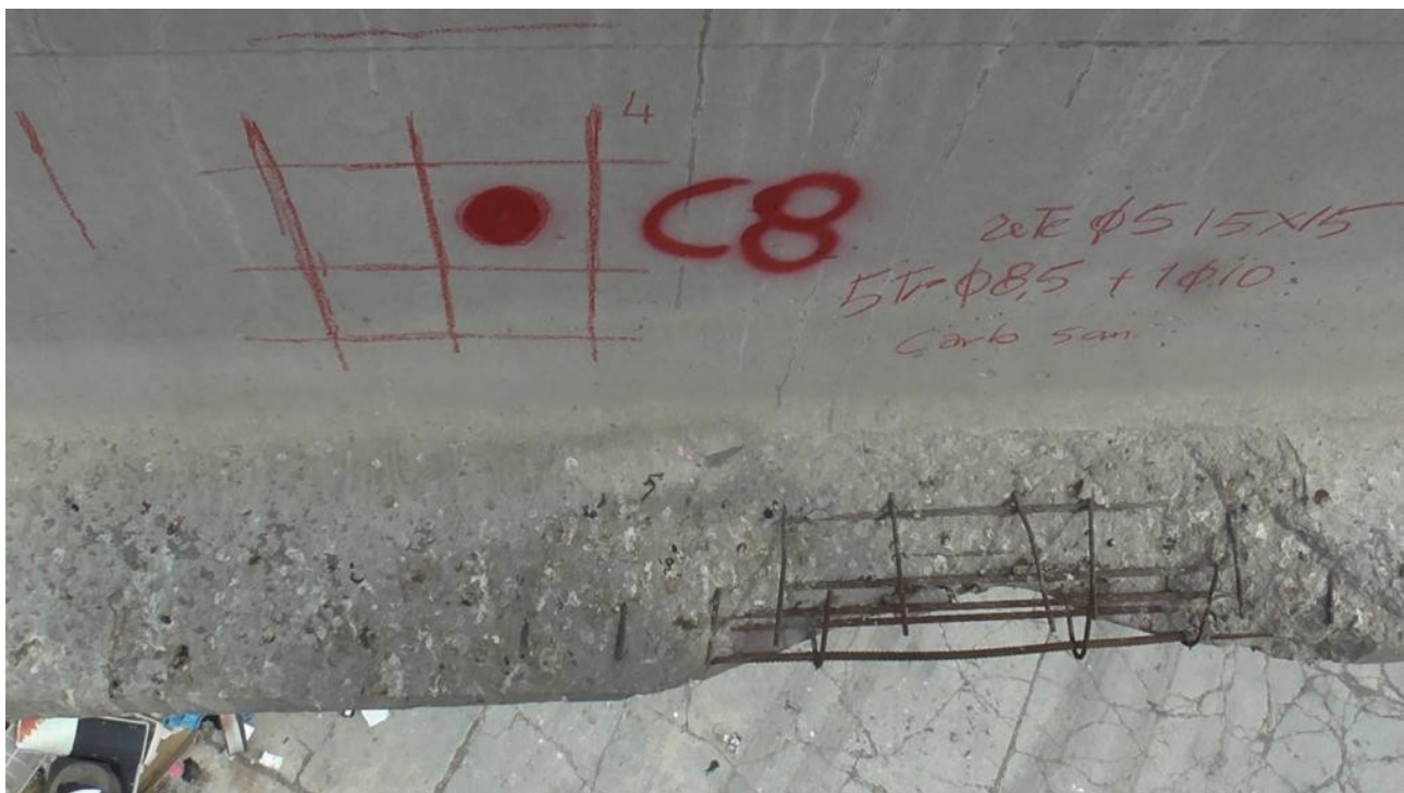
Fig.1.3.5-Travi di bordo con vecchi impatti con scopertura locale di alcuni trefoli e alcune staffe dell'ala inferiore
