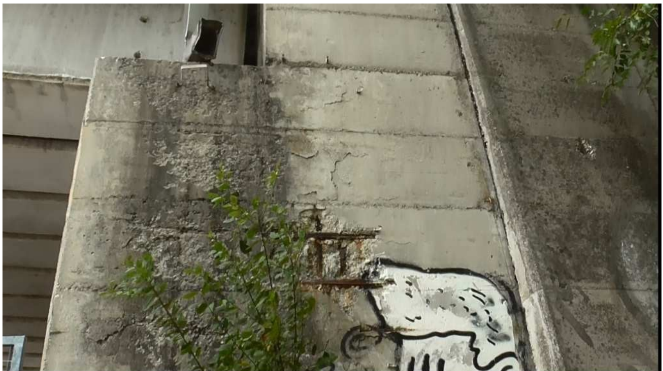
Fig.1.3.6- La faccia laterale delle spalle dal lato della pendenza trasversale presenta armatura in vista
