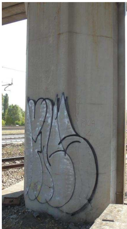
PILA4: copriferro in fase di distacco, viraggio a 3cm
