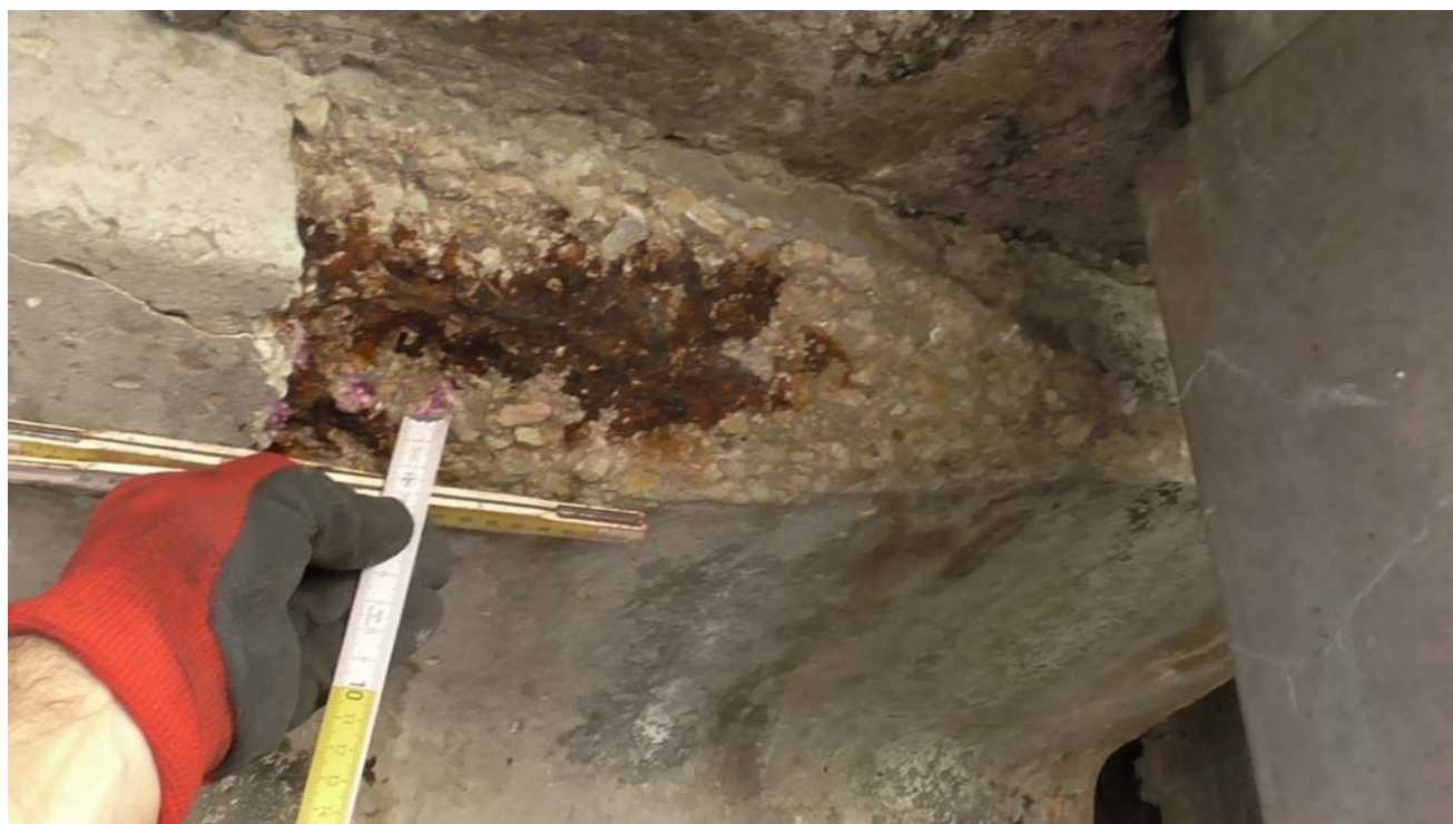
Fig.1.3.2-Degrado della zona di testata travi di bordo
