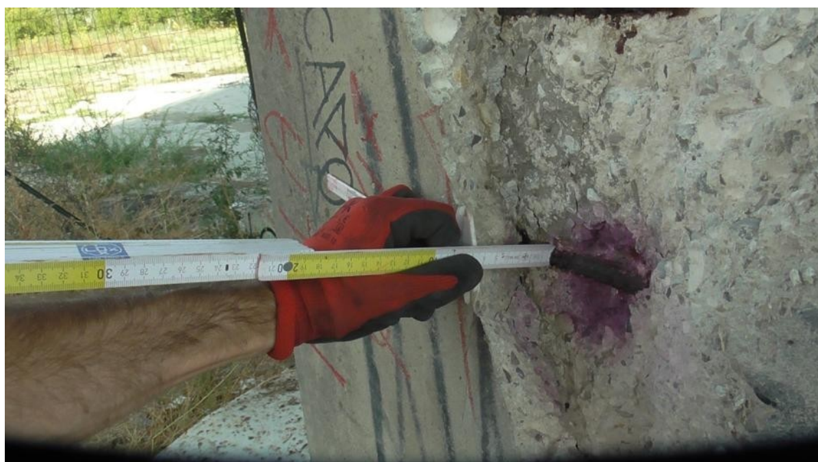
PILA7: alla base il copriferro di 5cm è facilmente rimovibile, si ottiene viraggio a 5-6cm di profondità, dietro a posizione delle staffe
