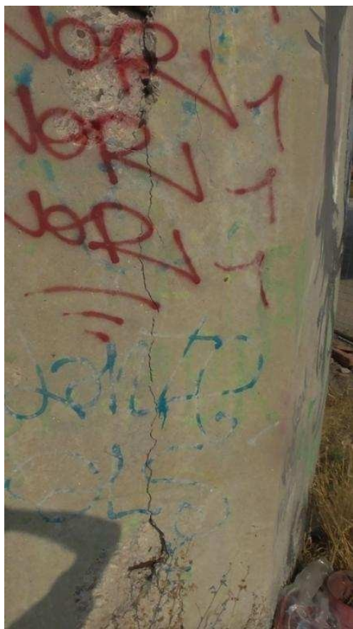
PILA8: copriferro in fase di distacco
