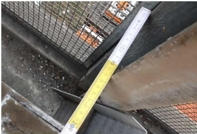
Fig.1.6.3-Le barriere di sicurezza sul ponte non sono conformi agli standard attuali
