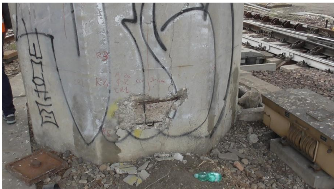
Fig. 1.5.1 - Base della pila 4, misure elettriche
