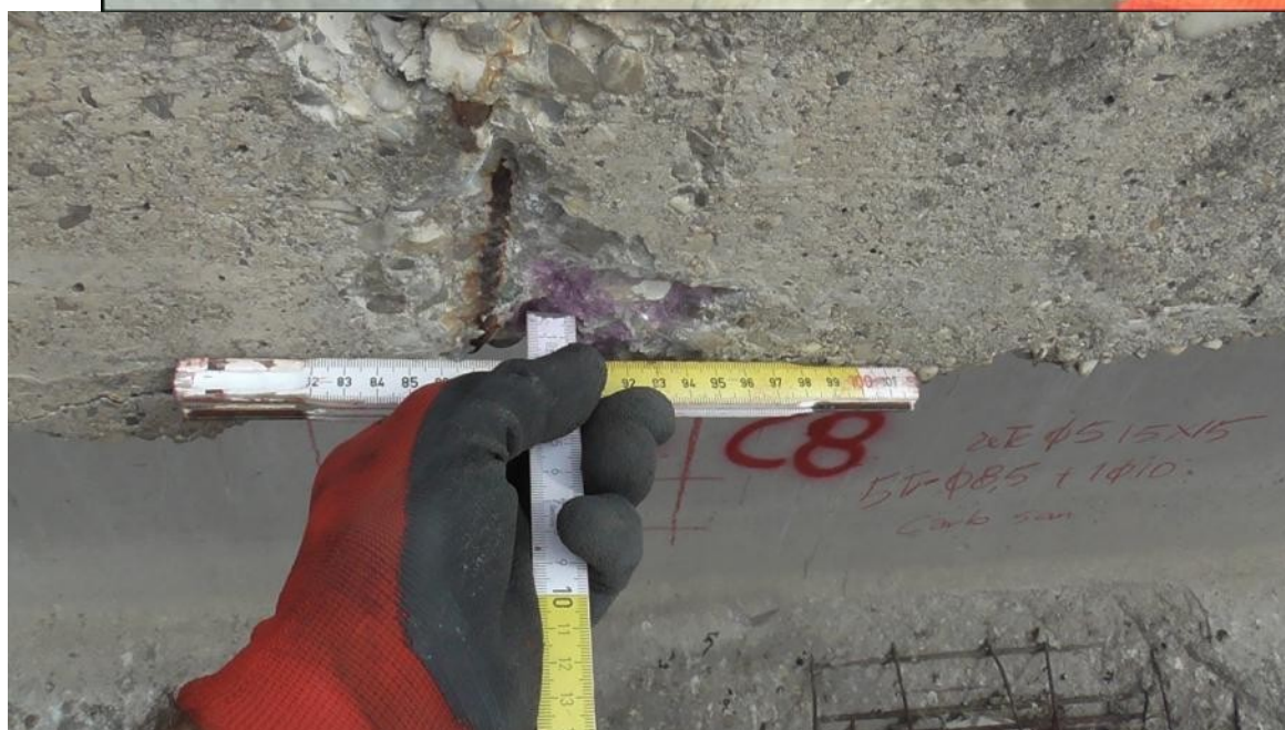
Fig. 1.3.4 - Degrado generalizzato all'intradosso soletta a sbalzo, non si ottiene viraggio a 3cm di profondità
