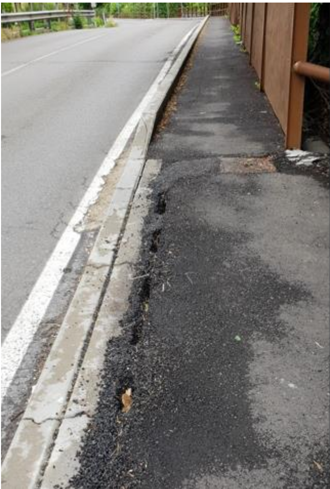
Foto n.2: Evidenti importanti cedimenti ed ampie fessure nell'asfalto
