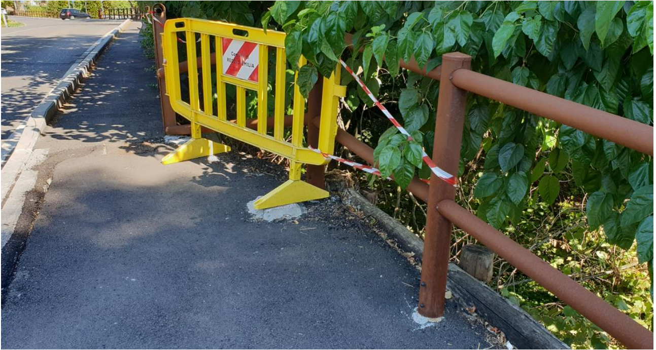
Foto n.3: Cedimento del terrapieno di contenimento
