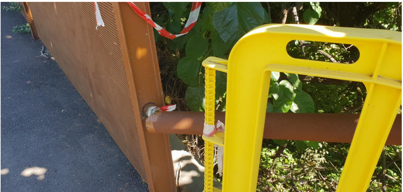
Foto n.4: Particolare del cedimento del parapetto di sicurezza in ferro lato torrente
