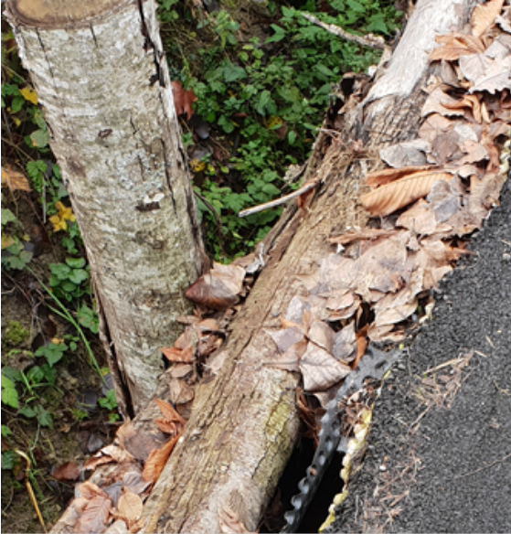
Foto n.3: Veduta del cedimento del terrapieno con evidente crepa a rischio infiltrazioni
