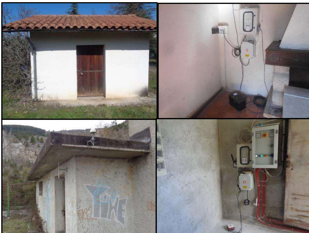
figura 1: Esempi di stazioni della RAN installate sul pavimento di piccoli edifici. Nelle foto a destra l'esterno dei piccoli edifici, a sinistra l'interno.
