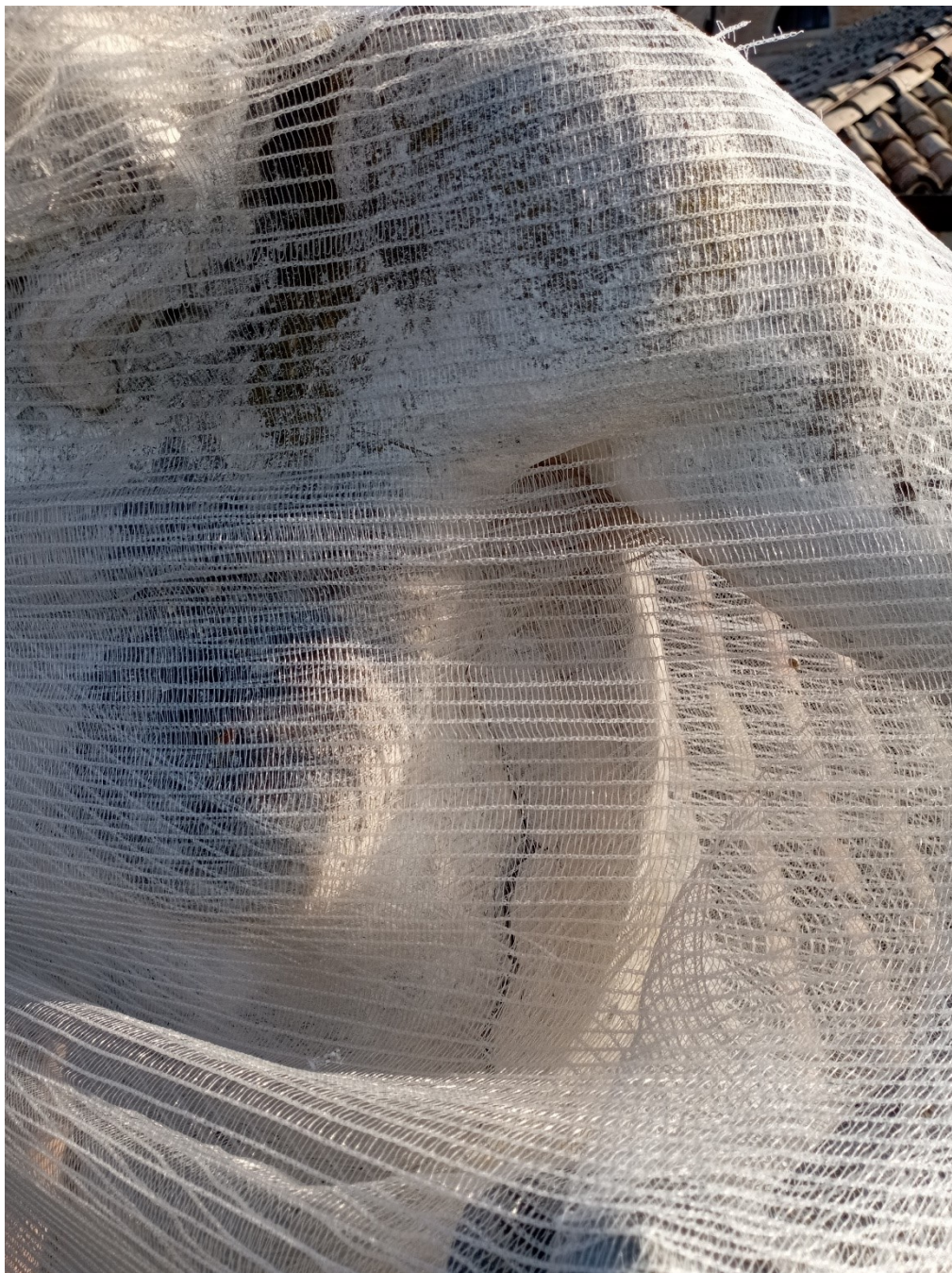
Il Vizio: lesione in corrispondenza del braccio sinistro
