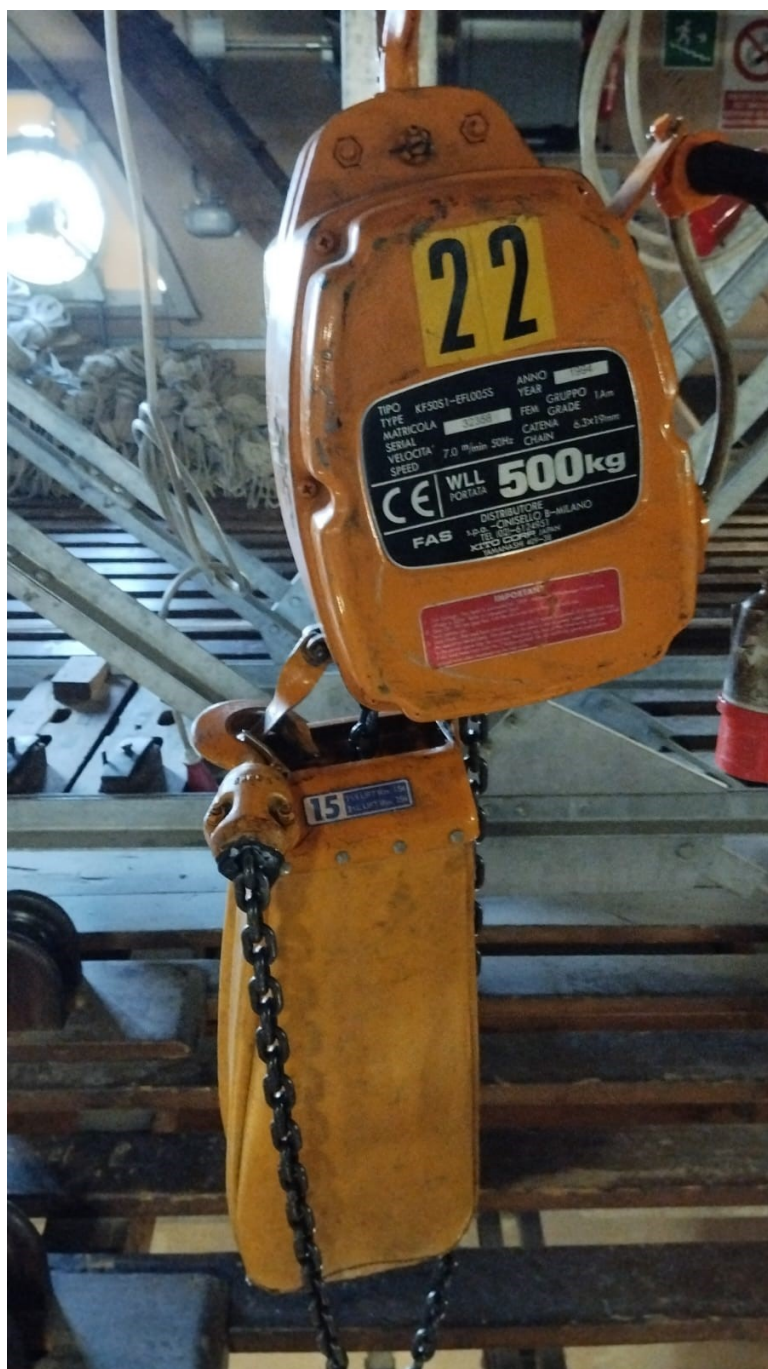
Attuali motori applicati alle strutture della graticcia
