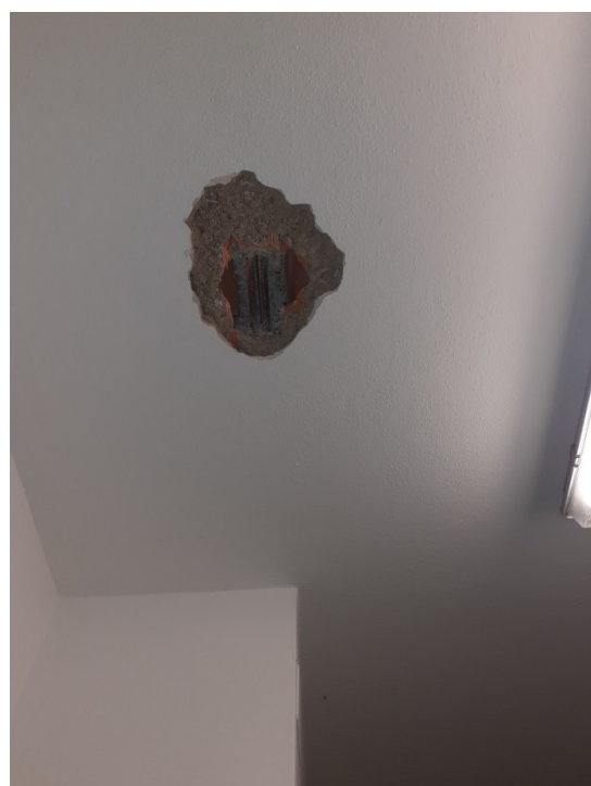
Foto n. 2 – zona antibagno al piano seminterrato
