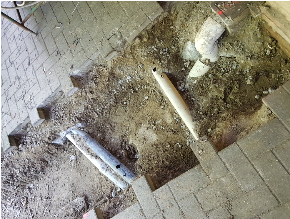
rinvenimenti impiantistici al di sotto della struttura metallica della scala.
