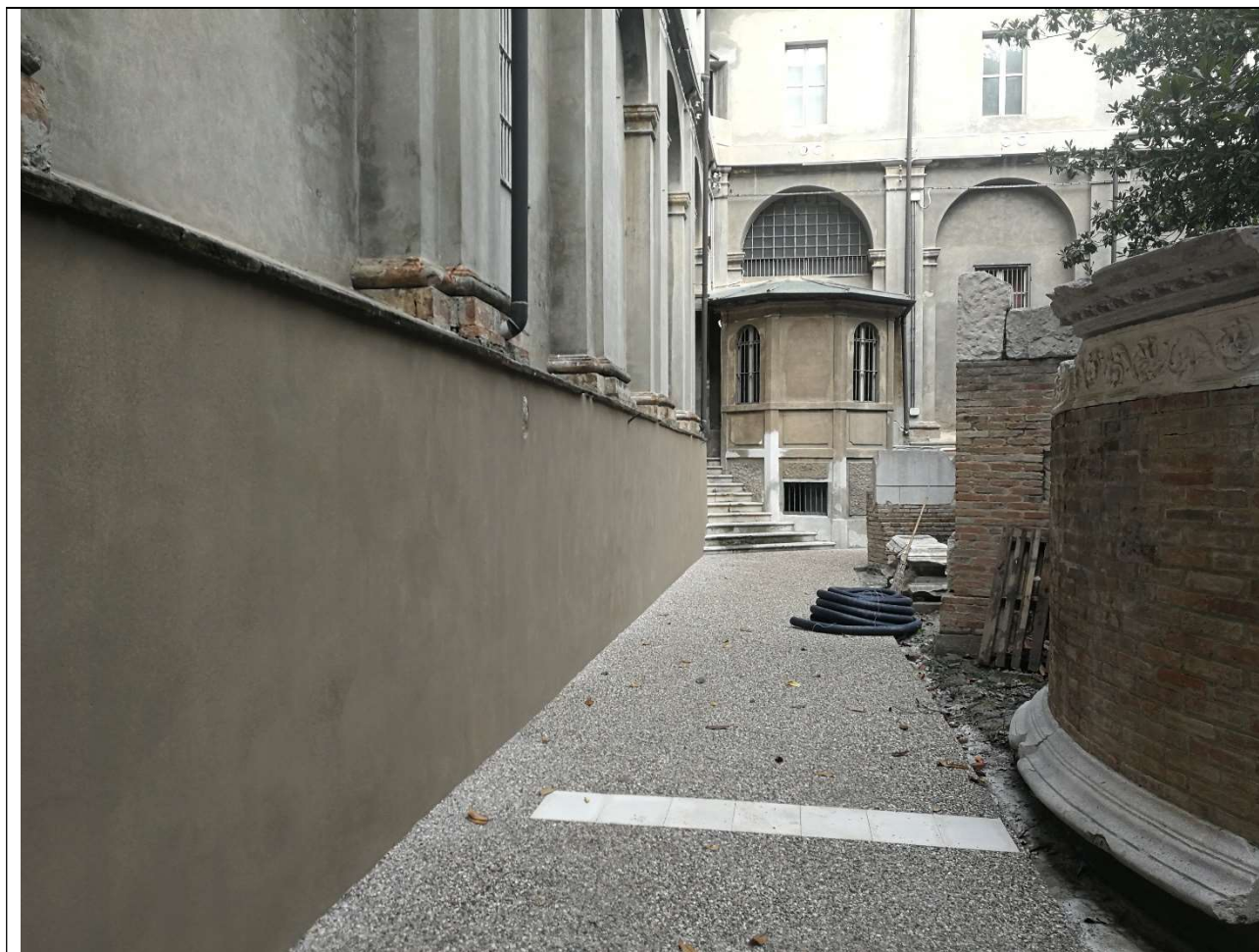
Parete Ovest – Edicola NW con necessità di estensione tinteggio
