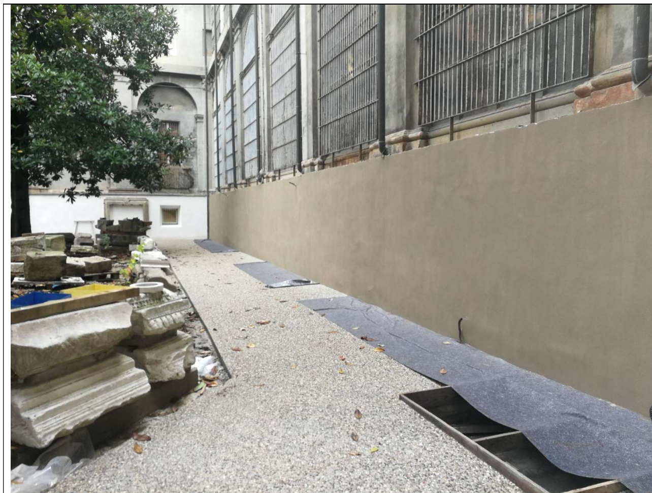
Parete SUD – Assenza di gocciolatoio
