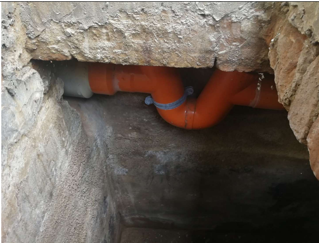
Angolo NE, pozzetto di ispezione con rete impiantistica dismessa da rimuovere
